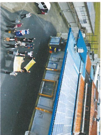
乳業会社の工場屋根に中古太陽光パネルを設置した、自家消費型の第5号発電所。
